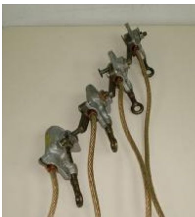
Figura 7. Arreglo en Cascada de la Parte Superior del Sistema de Protección Colectivo.
