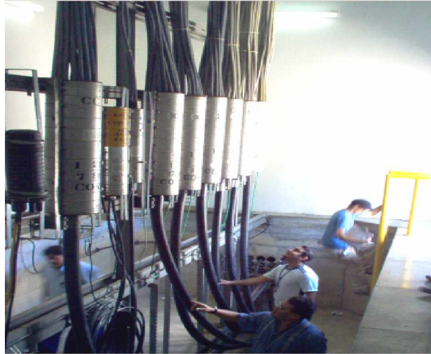
Figura 4 Fosa de cables
