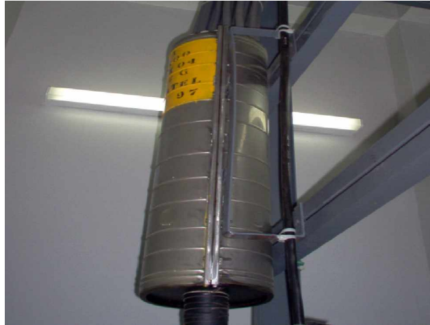
Figura 5 Equipo de Presurización
