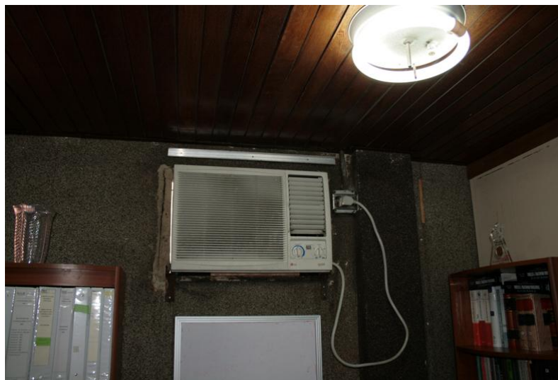
Fig. 19. Sistema de aire acondicionado del Archivo de Gestión de la Consultoría Jurídica de FUNDAPATRIMONIO
