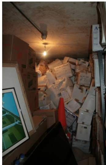
Fig. 21. Instalación eléctrica improvisada de luz amarilla que roza muy de cerca las pilas de cajas de documentos de archivo almacenados en el depósito resguardado por la Gerencia de Servicios Generales de FUNDAPATRIMONIO Autor: Fundación para la Protección y Defensa del Patrimonio Cultural de Caracas (FUNDAPATRIMONIO). Archivo Fotográfico de la Gerencia de Prensa
