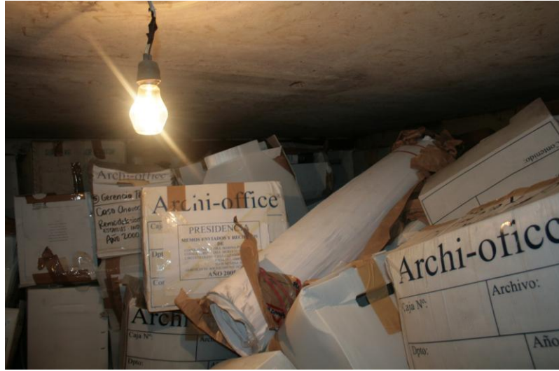
Fig. 20. Instalación eléctrica improvisada de luz amarilla sin protectores UV y sin sectorizar en el depósito resguardado por la Gerencia de Servicios Generales de FUNDAPATRIMONIO Autor: Fundación para la Protección y Defensa del Patrimonio Cultural de Caracas (FUNDAPATRIMONIO). Archivo Fotográfico de la Gerencia de Prensa
