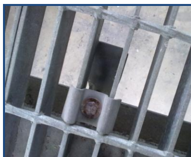
Figura 5.6 Grating de la estructura Noroeste 3
