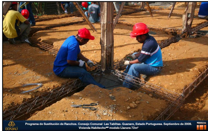
Ilustración II - 3. Acero de Refuerzo.
