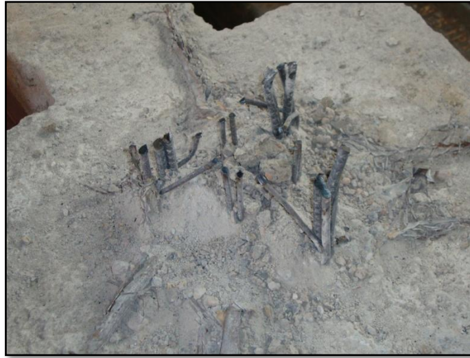
Ilustración V- 5 Acero Expuesto de la Columna.
