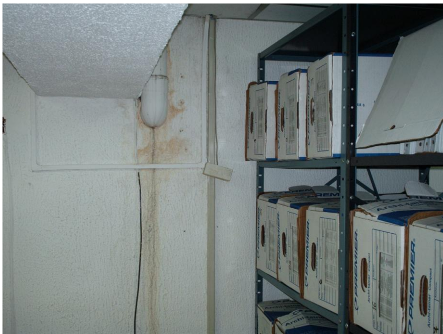
Filtraciones ubicadas en el archivo del piso nº 1.
