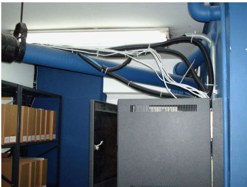
Central de Red de la Sede Actual de CONATEL que se encuentra dentro de las instalaciones de Archivo Central.
