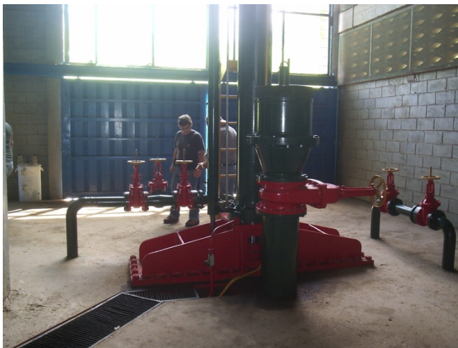
Imagen 16 Sala de válvulas
