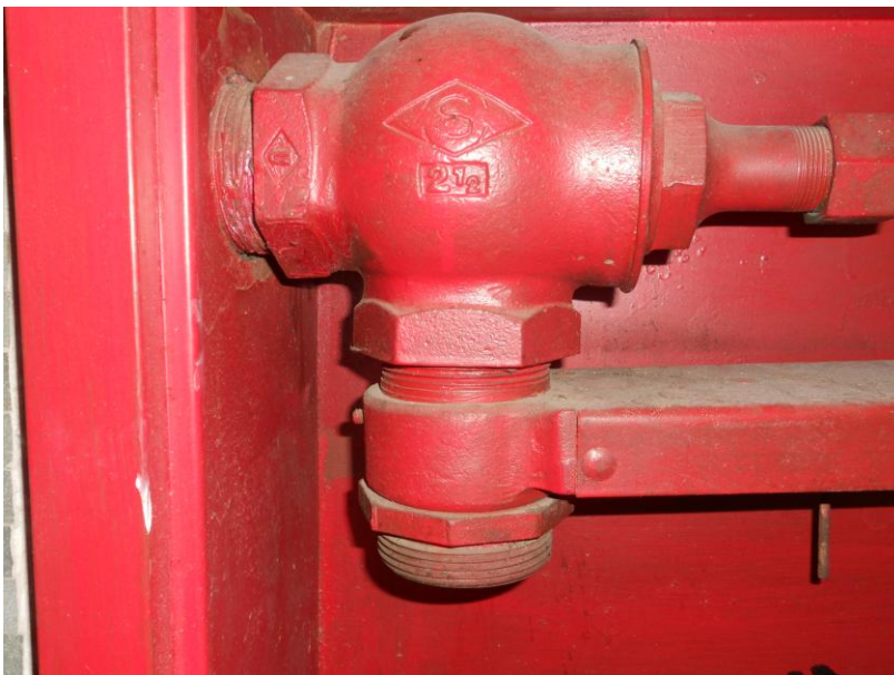
Anexo 31: Boca de agua que alimenta a la manguera perteneciente al sistema de extinción fijo. Ubicada en los Pisos 1 y 2
