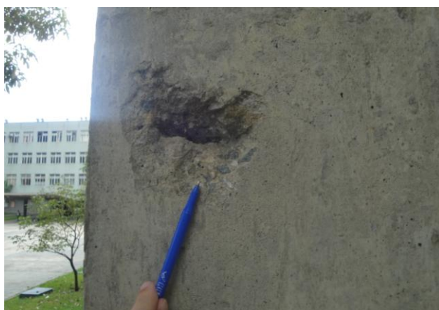
Figura 4. 24: Falta de recubrimiento y corrosión en Columna 1C11A FUENTE PROPIA
