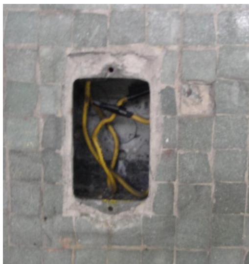
Anexo 37: Cableado perteneciente al circuito de luminarias. Ubicado en el pasillo del piso 2
