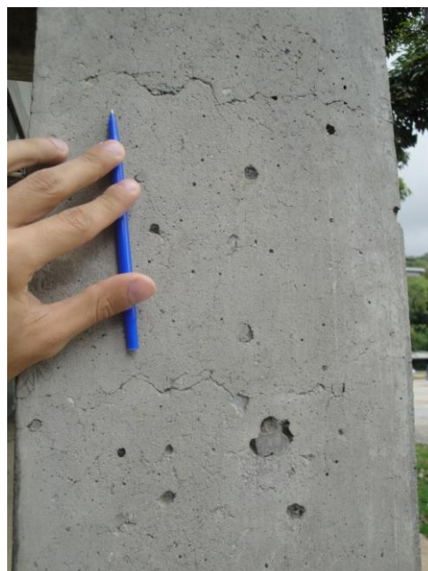
Figura 4. 23: Poros y grietas en 1C9A FUENTE PROPIA
