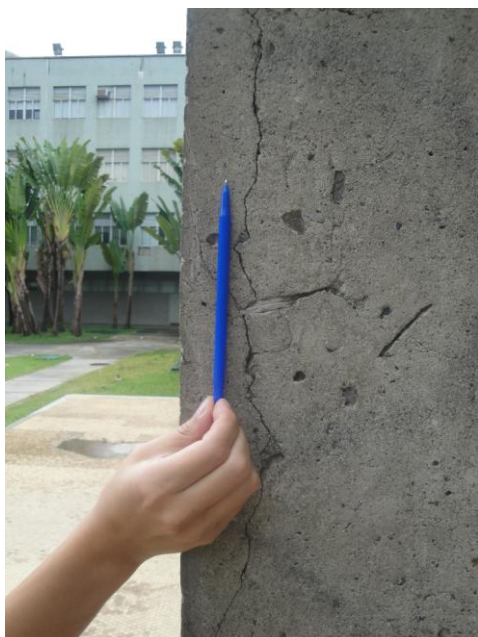
Figura 4. 22: Grietas en Columna 1C5A FUENTE PROPIA
