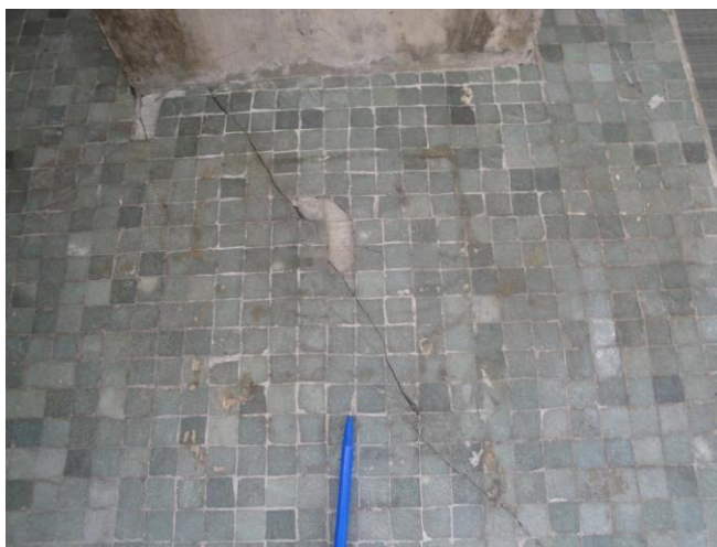
FIGURA 4. 27: DESPRENDIMIENTO Y DETERIORO DE MOSAICO EN LA PARED DE PB FUENTE PROPIA
