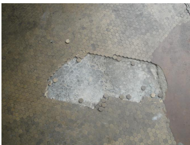
Figura 4. 26: Desprendimiento y deterioro de mosaicos en piso de PB FUENTE PROPIA
