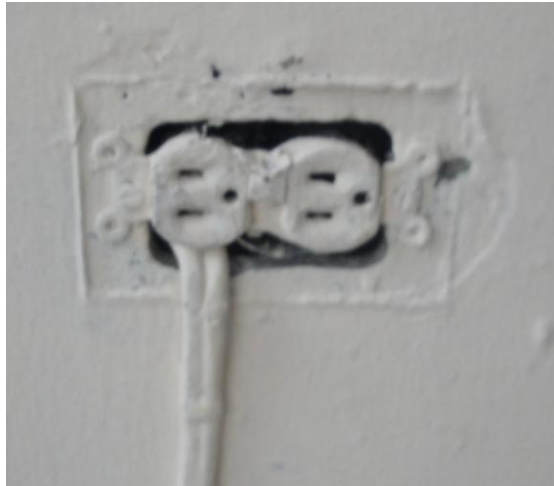
Anexo 33: Tomacorriente en mal estado. Ubicado en el FCU
