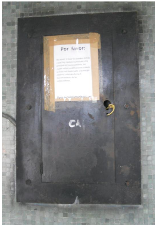
Anexo 34: Tableros de distribución o control. Ubicado en el Piso 1
