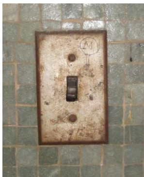
Anexo 32: Suiches en los circuitos. Ubicado en el pasillo del Piso 1
