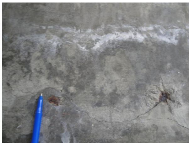
Figura 4. 25: Falta de recubrimiento, humedad, grietas y corrosión en Losa 1L3 FUENTE PROPIA
