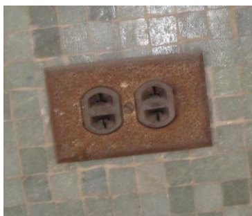
Anexo 39: Tomacorriente oxidado. Ubicado en el pasillo del piso 2
