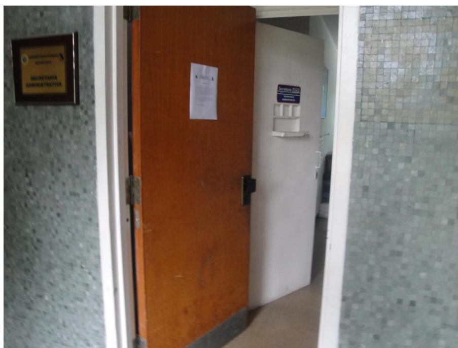
Anexo 13: Puerta sin sistema de retorno automático ubicada en la oficina de Secretaría Administrativa. Piso 2
