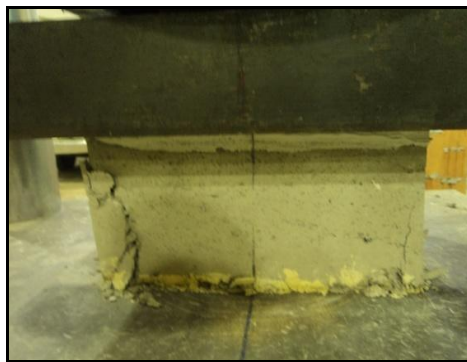
Imagen 39: Grietas perpendiculares a la carga aplicada
