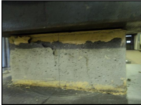
Imagen 41: Fisura paralela a la carga aplicada
