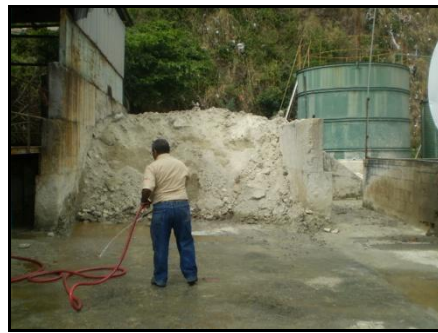
Imagen 14: Desechos de concreto premezclado
