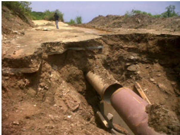
Foto 1. Colapso de tubería principal de la aducción Maya –Picure por movimientos en masa durante el período lluvioso
