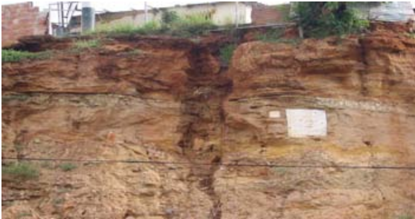
Figura 3. Cárcavas por infiltraciones en zanjas no revestidas
