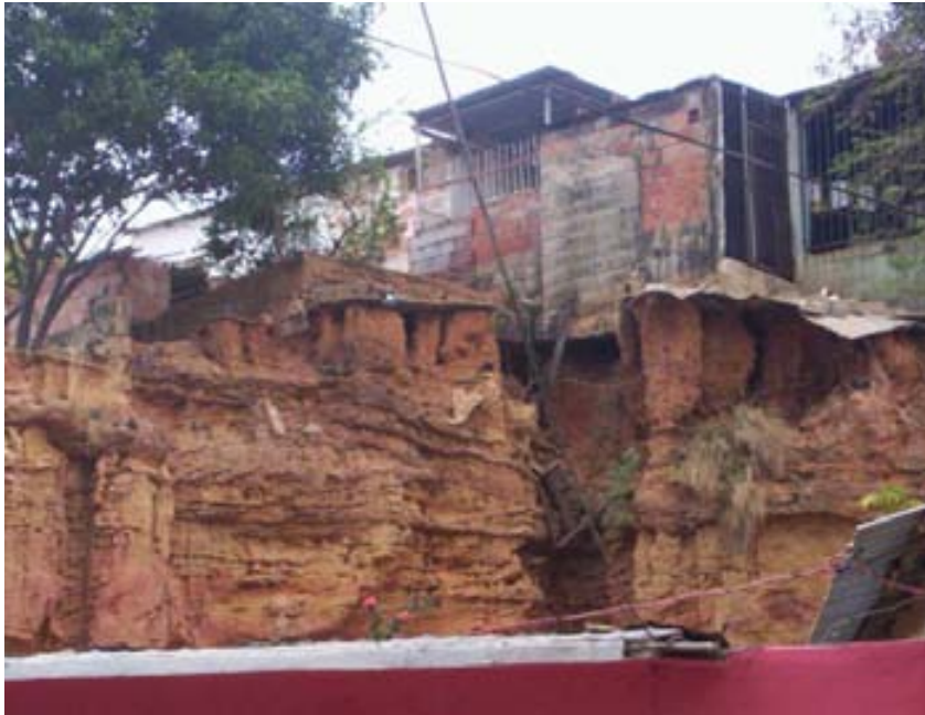
Figura 8. Vivienda artesanal sin soporte estructural al borde del talud. Barrio Cerros de Marín, Municipio Maracaibo, estado Zulia
