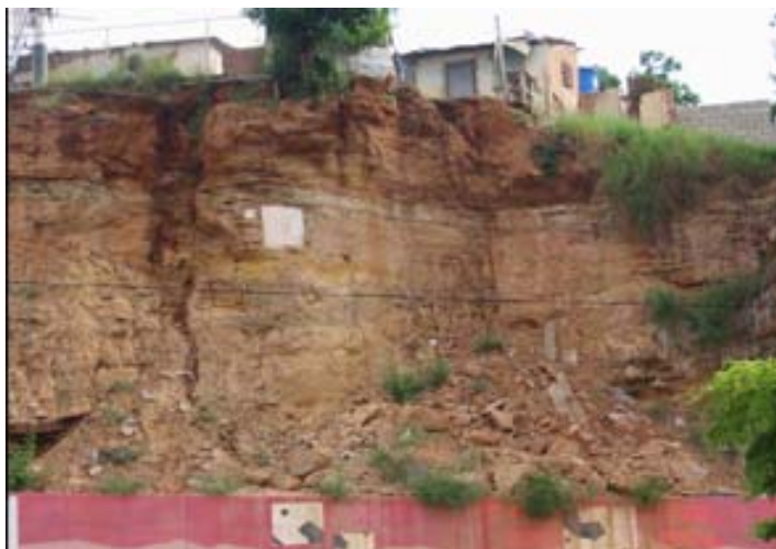
Figura 12. Viviendas ubicadas en áreas de derrumbes
