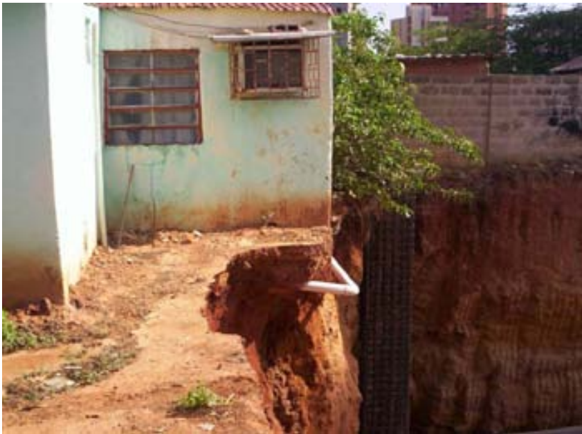
Figura 7. Excavaciones artificiales que generan derrumbes y deslizamientos
