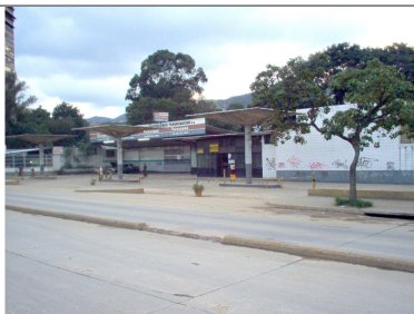
Figura 30 Vista del conjunto de cubiertas de paraboloides hiperbólicos en forma de paraguas invertidos ubicados en los cuales fueron demolidos en su totalidad
