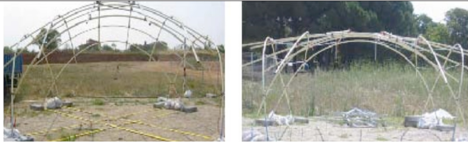
Figura 29 Pérdida de la geometría
