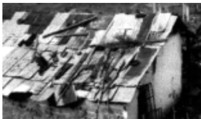
Figura 8 Ejemplos de patologías observadas en las cubiertas de las viviendas
