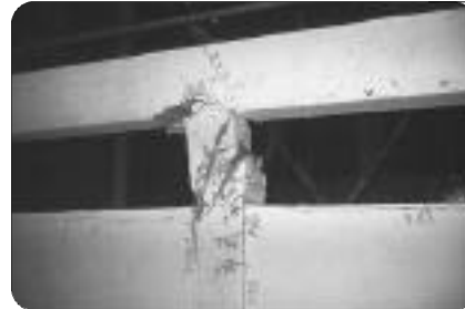
Foto 20: Falla por columna corta obtenida en el ensayo realizado en la Universidad de los Andes
