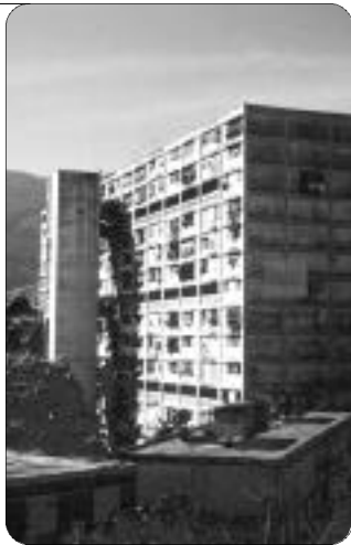
Fotos 8 y 9: Generación de columnas cortas por pretilas en pasillos, en edificios de vivienda masiva del Banco Obrero, Venezuela, en los años 50.
