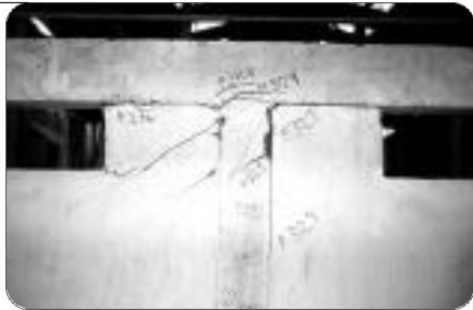
Foto 23: Estado de fisuración de la columna central al final del ensayo donde se ha cerrado parcialmente el vano que conforma la columna corta
