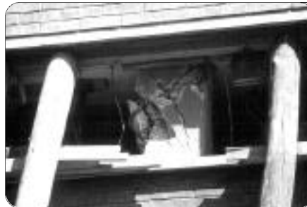
Foto 2: Detalle de la foto 1. Falla por columna corta en Pereira, Colombia, durante el sismo de noviembre 23 de 1979
