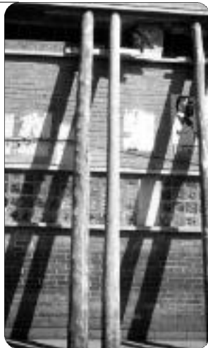
Foto 1: Falla por columna corta en Pereira, Colombia, durante el sismo de noviembre 23 de 1979
