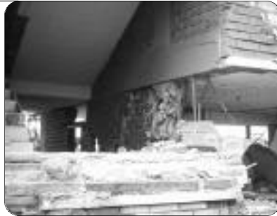
Foto 12: Falla en columna corta generada por el adosamiento del descanso de una escalera, durante el sismo de Popayán, Colombia, marzo de 1983
