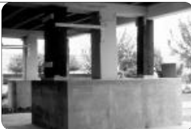
Foto 14: Falla en columna corta generada por el confinamiento parcial de la columna por un elemento muy rígido en el sismo de El Centro, California (Colección del Earthquake Project, Emergency Service Office of the Governor of California)
