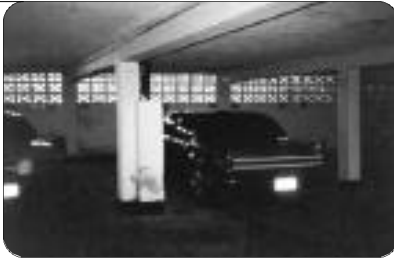
Foto 13: Generación de columna corta por embonamiento (protección) de tubería que se adosa parcialmente a una columna en estacionamiento de vehículos
