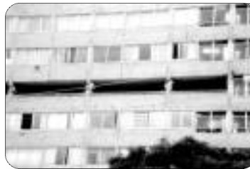
Foto 11: Detalle de la foto 10. Falla de columnas cortas en Ciudad de México, México, durante el sismo de octubre 18 de 1985 (Colección del Earthquake Project, Emergency Service Office of the Governor of California)
