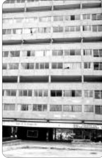
Foto 10: Falla de columnas cortas en Ciudad de México, México, durante el sismo de octubre 18 de 1985 (Colección del Earthquake Project, Emergency Service Office of the Governor of California)
