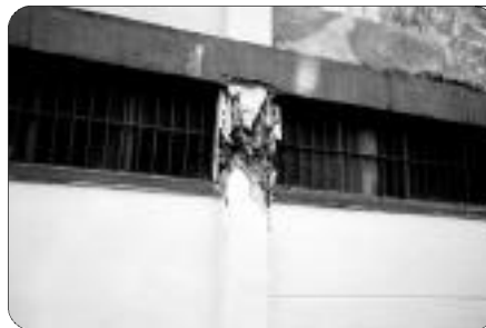
Foto 3: Falla de columna corta en Armenia, Colombia, durante el sismo de enero 25 de 1999
