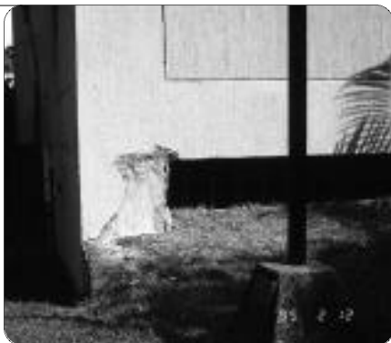
Foto 18: Columna corta causada por la abertura para ventilación de un semisótano en Pereira, Colombia, durante el sismo de febrero 8 de 1995
