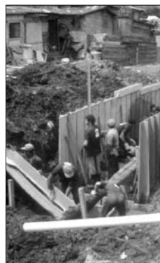
Figura 2: Mejoramiento de favela utilizando componentes prefabricados de “argamasa armada”. (Foto: P.E. Fonseca).
