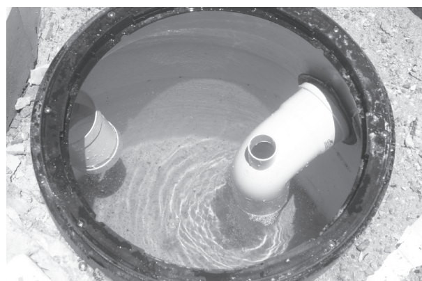
Foto 4 Cámara de cloración de planta prototipo
