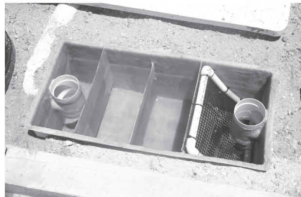
Foto 2 Cámara de Rejillas con criba plástica y trampas de grasas y arenas de Planta Prototipo
