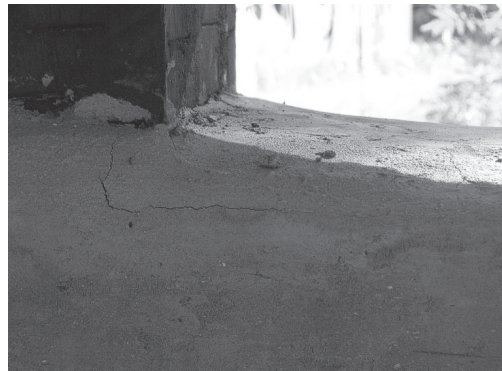
Foto 14 Fisuras en borde superior después de aplicado el enlucido
