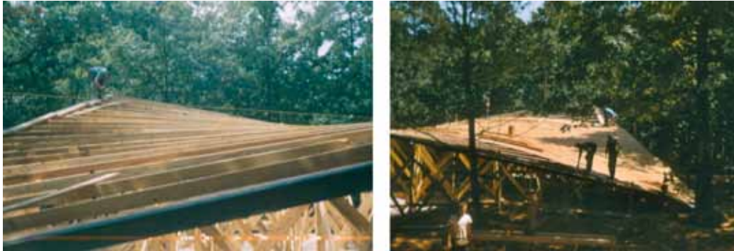
Figuras 7 y 8. Montaje de la cubierta de paraboloides hiperbólico de la Casa Raleigh
