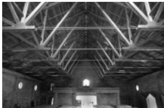
Fuente: Estructura de techo. Iglesia diseñada por Urbano Ripoll. Bogotá. Colombia (foto: A. Loreto).
