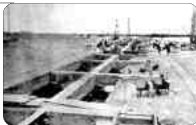
Foto 5: Trabajos en el muelle de Puerto Cabello, con las vigas de acero recubiertas de concreto
