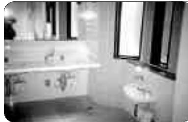
Foto 6: Detalle de lavamanos en baño de la consulta externa. Hospital Universitario de Tokio
