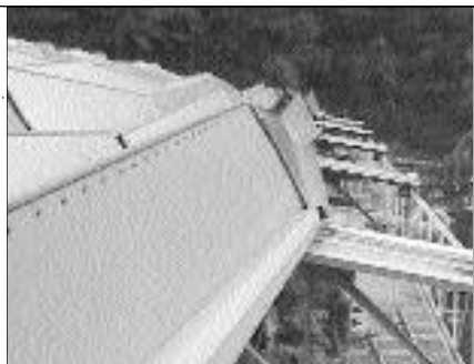
Figura 47 Tubo de refuerzo lámina de arrastre.
