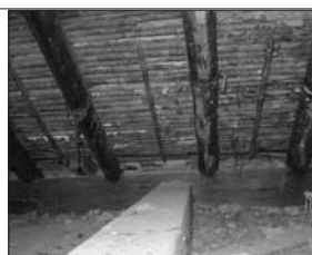
Figura 12 Cobertura de entramado de Caña Brava y base estructural de pares de madera rolliza, vigas soleras y tirantes aserrados.
