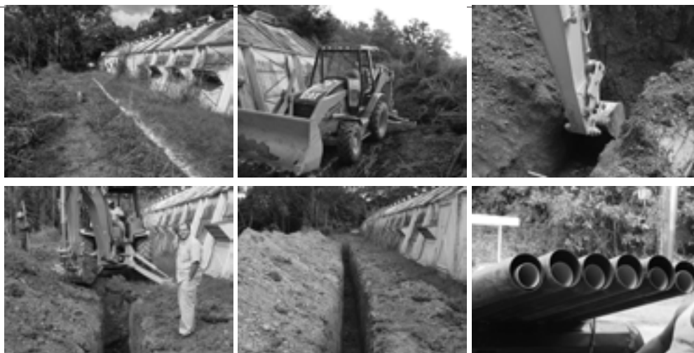
Foto 2 Excavación de la zanja de 2 m. de profundidad y 30 m. de largo. Tubos PVC de Ø 4" y 6"
