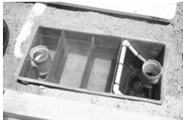
Foto 2 Cámara de Rejillas con criba plástica y trampas de grasas y arenas de Planta Prototipo
