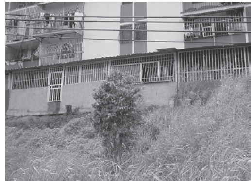
Foto 9 Crecimientos informales de áreas de apartamentos en planta baja.
