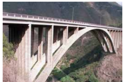
Foto 2. Arcos de concreto armado del Viaducto N° 2 de la Autopista Caracas-La Guaira.
