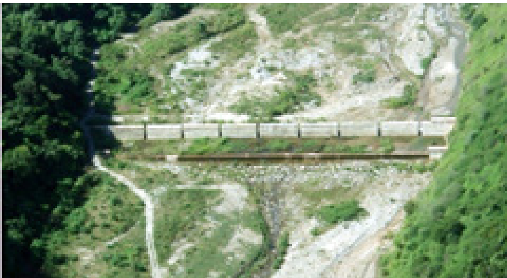
Figura 26. Vista aérea de la presa abierta de concreto ciclópeo de 5 m de altura construida en el río Naiguatá. Foto tomada en 2008 recién construida la obra. Obsérvense las ranuras en el cuerpo de la presa y el contradique a unos 20 m del dique principal. El ancho del cauce es de 155 m.
