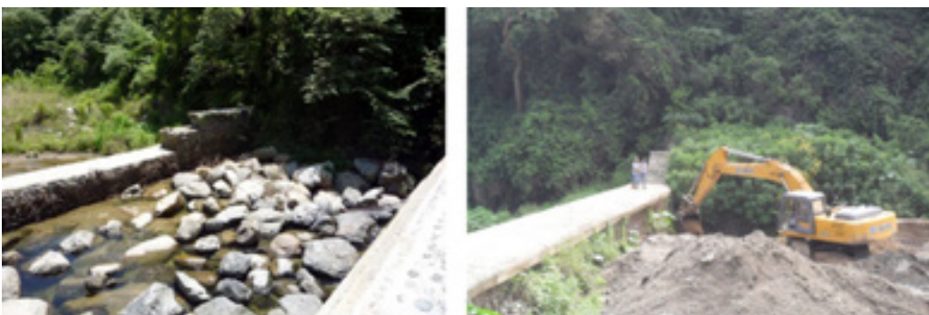
Figura 30. Río Migueleno. Situación ideal de rocas de protección en el lecho entre el dique y el contradique (foto izquierda: Sanabria, 2016) y saque inapropiado del material aguas arriba de la presa (foto derecha: Barreto, 2014).
