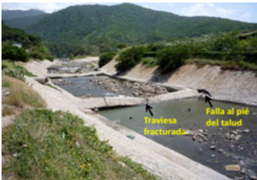
Figura 24. Daños en traviesas de la canalización del río Camuri Grande por socavación aguas abajo.
