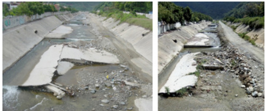
Figura 25. Daños en las losas de la canalización del río Naiguatá. Foto izquierda de mayo del 2011 y foto derecha de diciembre 2017.
