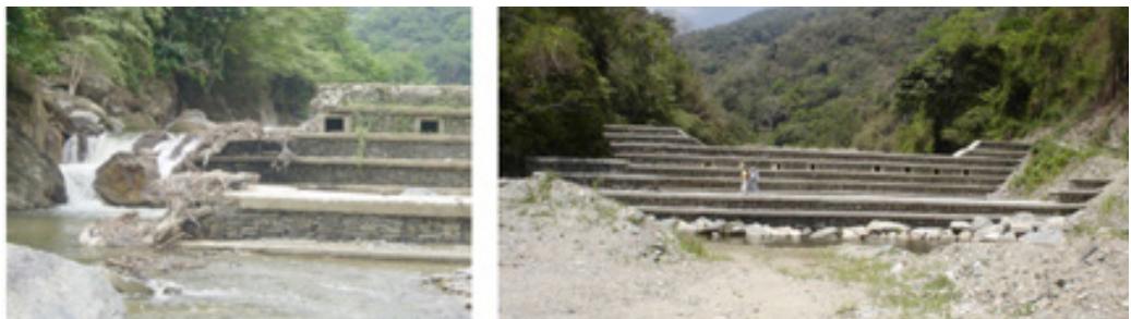
Figura 19. Daños por impacto de bloques producto de derrumbes en el talud derecho de la presa N° 3 del río Camurí Grande. Foto izquierda mirando la brecha desde aguas abajo hacia aguas arriba (11/05/2011). Foto derecha, recién construida la presa en mayo 2008.
