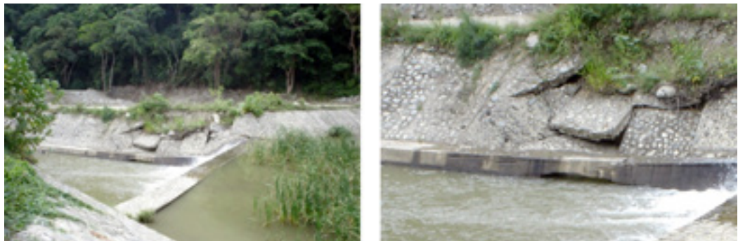
Figura 23. Vista de la falla en los taludes de la estructura de transición al inicio de la canalización del río Migueleno. Se observan losas fracturadas en peligro de desplomarse al río con el paso de las crecientes y socavación en el pie del muro de la canalización (2011).
