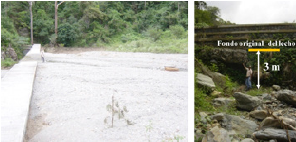
Figura 17. Vista frontal de la presa abierta de ventanas construida en gaviones en Camurí Chico. Foto (izq.) recién construida. Foto (der) tomada en 2011 muestra erosión de 3 m. por degradación general del lecho causada por los flujos de aguas claras en la creciente de diciembre de 2010.
