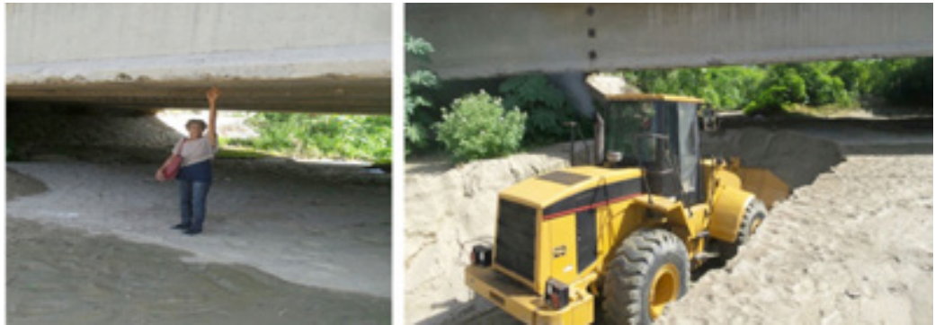
Figura 18b. Izq.: la luz del puente era de tan solo 2 m debido a la sedimentación, cuando la profundidad del canal es de 4 m. Der.: trabajo de maquinarias removiendo la terraza sedimentaria de 2 m de espesor debajo del puente (Fotos de Mariela Gómez, 2016).
