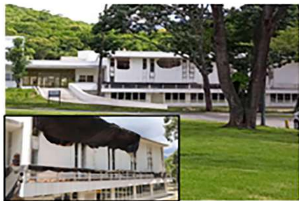
Figura 4. Aspecto exterior del Instituto Anatomopatológico con reparaciones realizadas durante la remodelación de la institución. Cortesía del Dr. Enrique López-Loyo- En el recuadro detalle de las modificaciones realizadas en la fachada.
