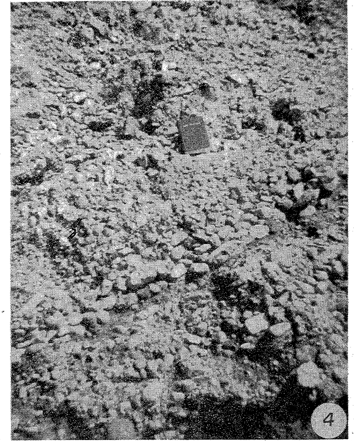
FOTO 4.- Detalle de canal colmatado de tipo torrencial, Carretera Los Potocos-Caigua.
