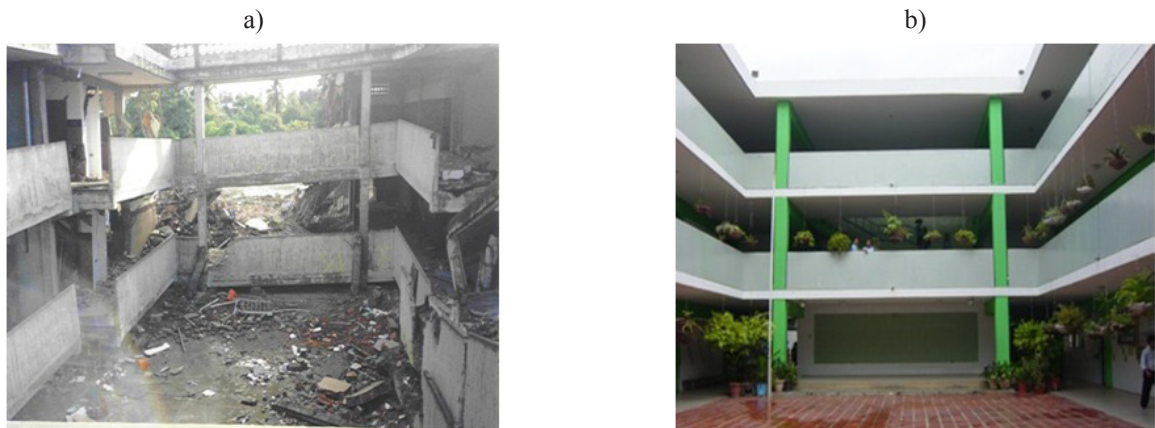
Figura 12. (a) Escuela del tipo Cajetón derrumbada en el sismo de Cariaco de 1997; (b) Escuela similar localizada en varios lugares del país
