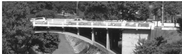
Figura 9. Puente PV-UCV visto desde el tubo de agua hacia el oeste. Se usó cámara digital el día 15 feb. 2006, casi un año después de la creciente.
