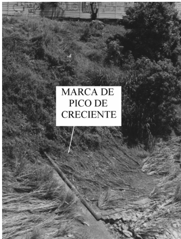
Figura 11. Marca de creciete cerca del puente PV-UCV (Margen izquierda, Norte) dejada por la creciete del 8 Feb. 2005 5:27 PM HLV. Foto del 12 Feb. 2005.
