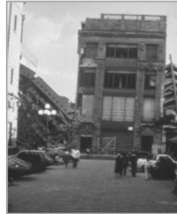
Figura 38. Choque entre edificaciones. Terremoto de México 1985 (Fuente: Bachmann, 2003 )
