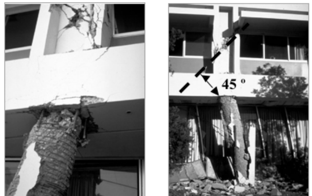
Figura 30. Problema de San Fernando California 1971. Transición de columna (Fuente: Bertero, 1971)
