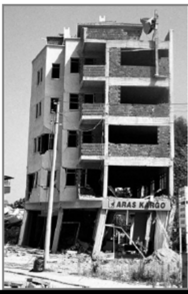
Figura 24. Dirección poco resistente a fuerzas laterales debidas a sismos (Fuente: Sezen et al. 2003)
