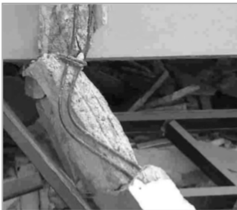
Figura 34. Falta de acero transversal (Fuente: D'Ayala et al. 2003)
