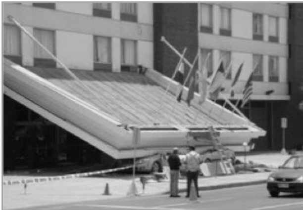
Figura 19. Colapso de cornisa en Hotel Radisson. Terremoto de Quillahuá – Chile ( 2007)
