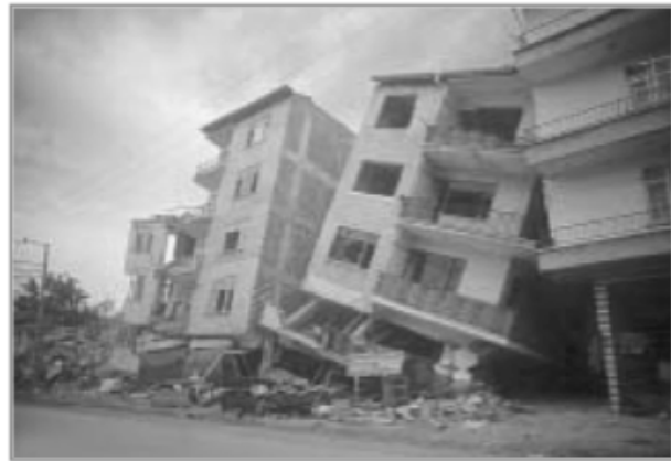
Figura 17. Desplazamiento lateral y ruptura de columnas (Fuente: Arslan & Korkmaz, 2006)
