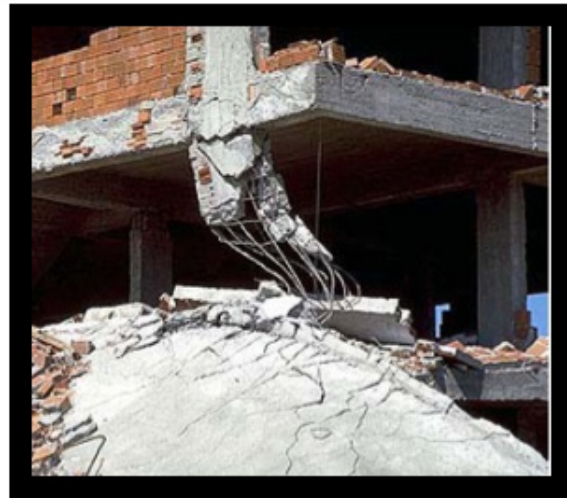
Figura 42. Daño severo en columna (Fuente: Arslan & Korkmaz, 2006)
