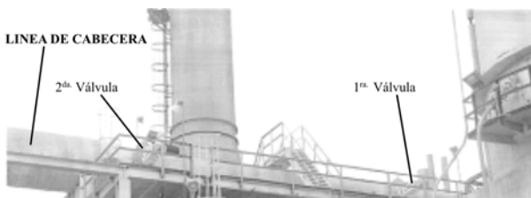
Figura 1. Sistema de válvulas de control en la línea de cabecera.
