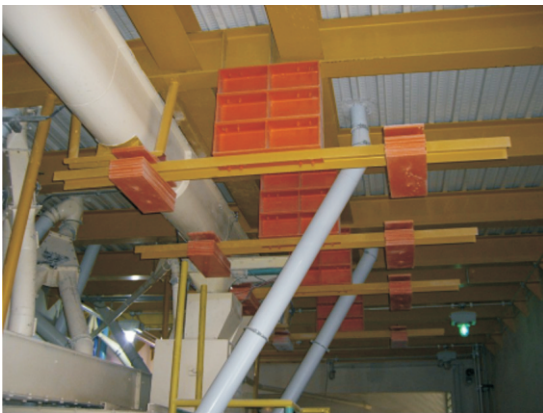
Figura 12. Fotografía de los amortiguadores dinámicos de vibración instalados.
