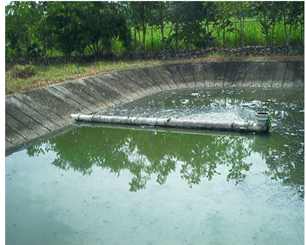
Figura 15. Laguna Facultativa de 20 m x 30 m, implementada en Caño Seco, Municipio Alberto Adriani, Zona Panamericana del Estado Mérida. Observación en campo de la zona de estancamiento localizada en el extremo derecho aguas abajo.
