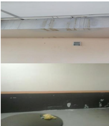
Figura 1. Estado de Paredes y Techos
