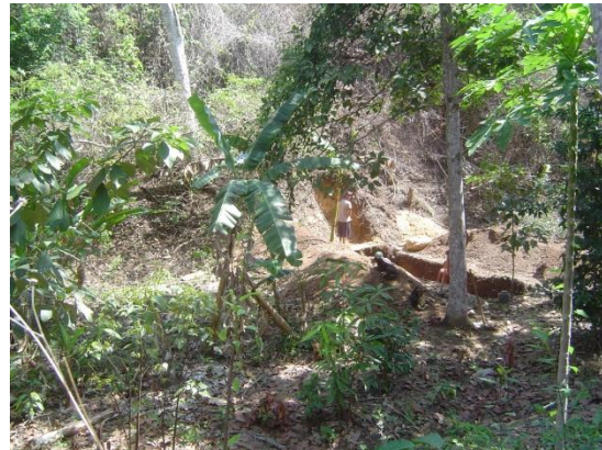
Figura 10. Excavación realizada a mano, por limitaciones de espacio, rugosidad de la topografía y vocación agrícola del terreno, de la trinchera de Yaritagua, a través del segmento Boc-e de la falla de Boconó.
