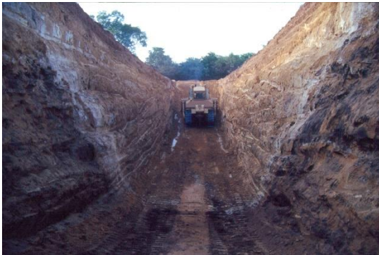
Figura 7. Excavación de trinchera Hato La Pica a través de la falla de Ancón, en las llanuras de Buchivacoa (estado Zulia oriental), con tractor D-8, de pala de 4 m de ancho, lo cual condicionaba excavaciones con dimensiones de: 80-90 m de largo, 8 m de profundidad y sección trapezoidal de 8 m de ancho al tope y 4 m a la base; y remociones de material de 2.500-3.000 m 3 . Apréciase en primer plano zona encalichada (blanquecina) que resalta la zona de falla.
