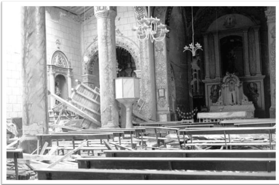
Figura 6. Ruinas en el interior de la Iglesia de la Concepción, El Tocuyo, tras el colapso del techo (Foto: cortesía de Lermít Figueira, 2016).
