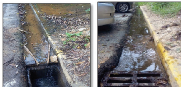
Figura 5. Lado izquierdo: Fuga de agua detectada en la entrada de la Escuela de Física. Lado derecho: fuga de agua en el estacionamiento este
