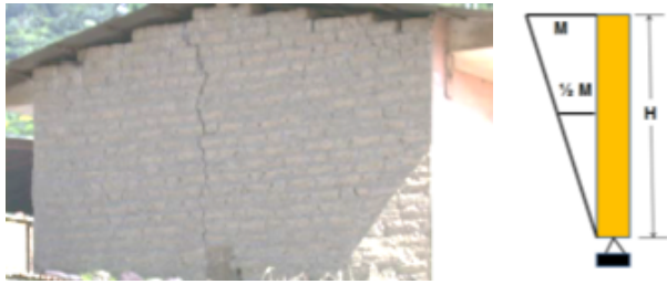
Figura 6. Propagación de la falla por flexión en el centro del muro y variación del momento flector “M” en la altura
