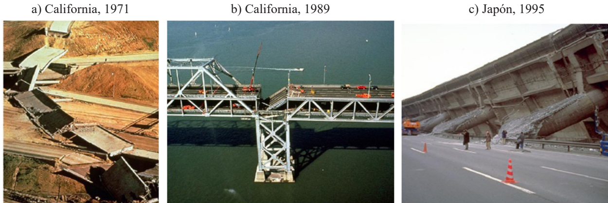
Figura 9. Puentes derrumbados en California y Japón que habían sido diseñados para resistir terremotos
