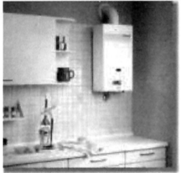
Figura 12. Instalaciones y equipos a gas para calentar agua
