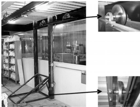
Figura 3. Detalles del montacargas construido para el SASMP
