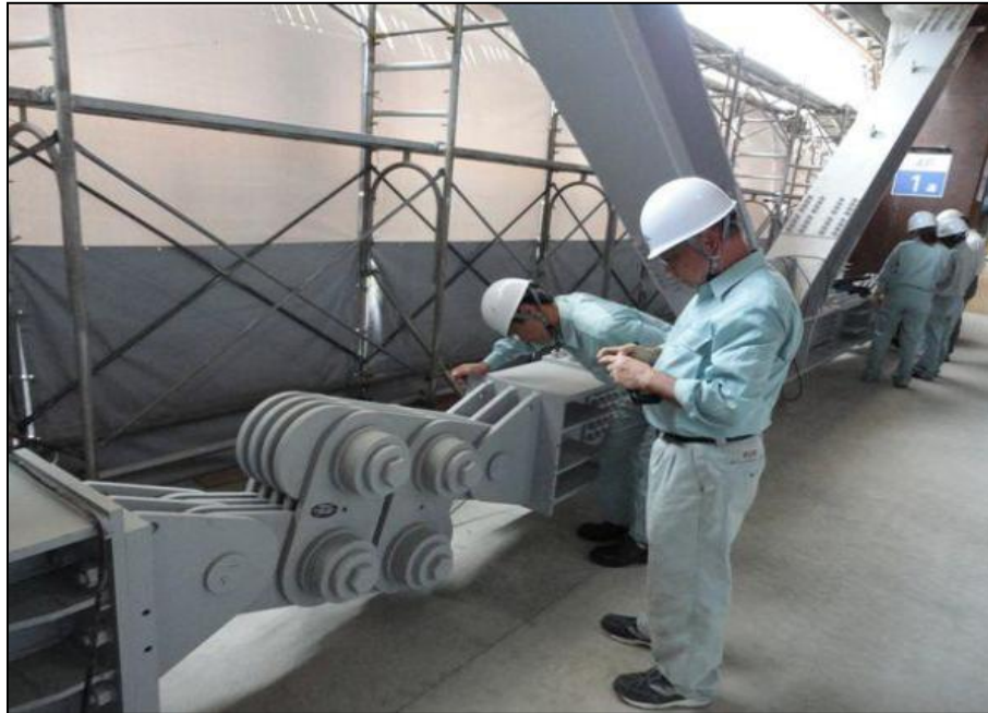
Fig. 27. Instalación de un dispositivo de 2250 kN de capacidad en un pórtico estructural. Fuente: I.H. Mualla, L. O. Nielsen, M. Sugisawa y Y. Suzuki. Large Capacity Dampers for Buildings and Structures (2012)
