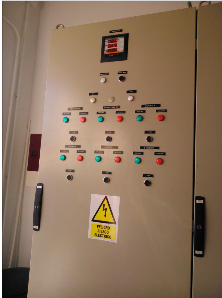
Figura 17: Vista de un tablero de control de la E.D.A.R.
