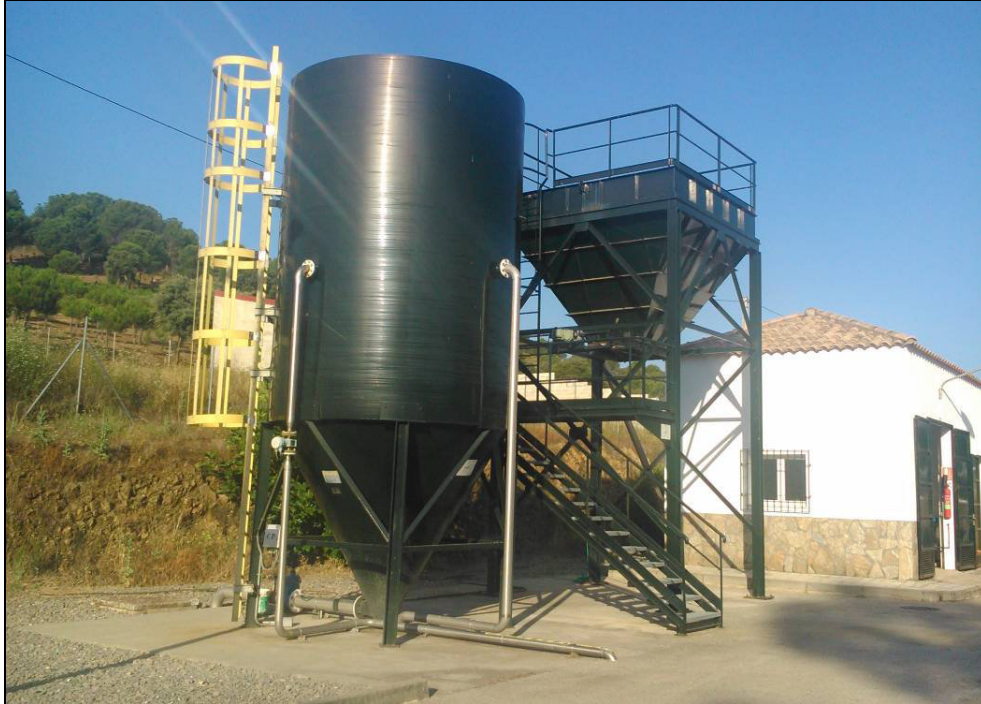
Figura 16: Unidad espesadora de fangos en primer plano junto a tolva de almacenamiento de fangos deshidratados
