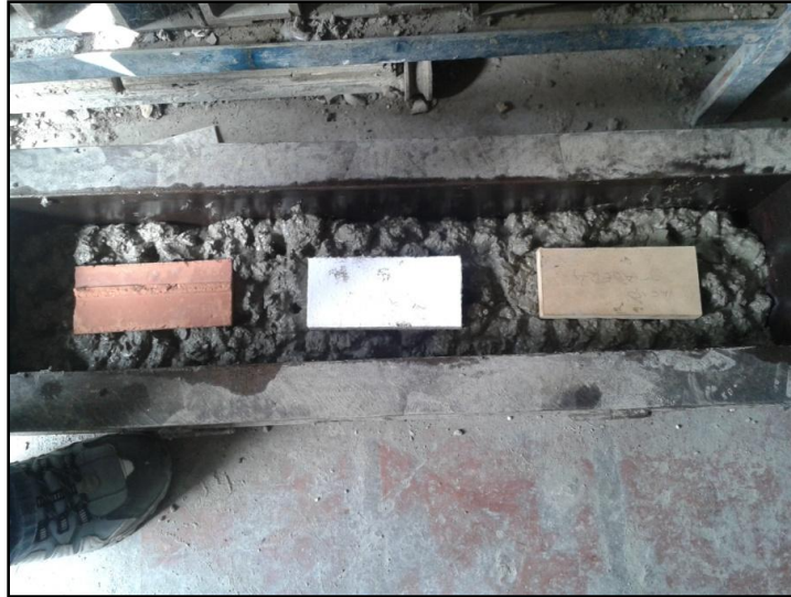
Figura 15. Vaciado de viga con vacíos planos.
