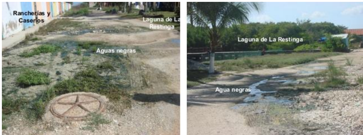
Figura N° 26. Pozos sépticos desbordados [46].
