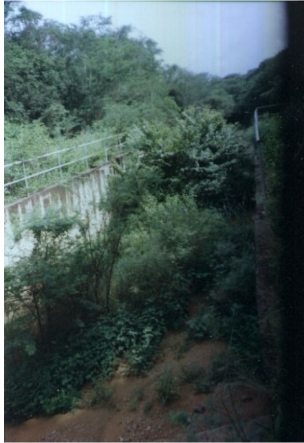
Foto 5.5. Pozo dissipador colmatado y con abundante vegetación. Embalse “El Cují”.
