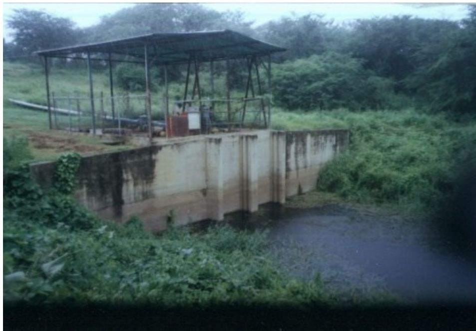
Foto 17. Obra de Toma para el acueducto de Onoto (operada por Hidro-Caribe). Embalse "El Cují".
