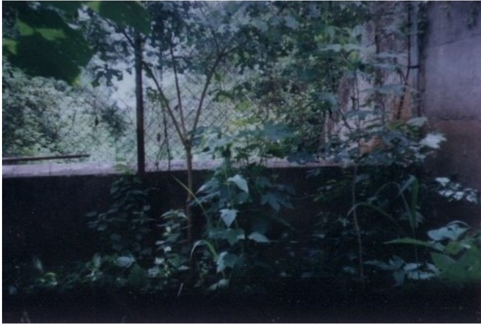
Foto 5.14. Reja alfajol ubicada sobre el cimacio. Embalse "El Andino".
