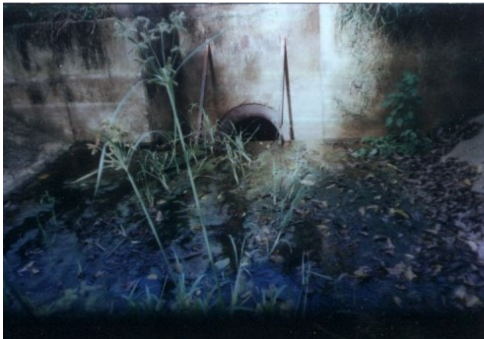
Foto 10. Tubería ubicada debajo de una carretera de tierra, canal de descarga de la toma para riego. Embalse "El Cují".
