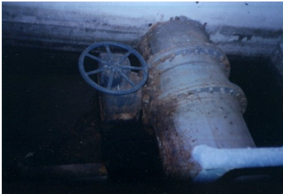
Foto 5.8. Válvula de emergencia (mariposa), se observa la inundación en la cámara de maniobras. Embalse “El Cuji”.
