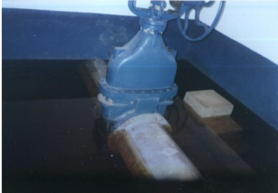
Foto 5.22. Válvula de compuerta utilizada para regulación. Se observa la inundación de la cámara de maniobras. Embalse “El Andino”.
