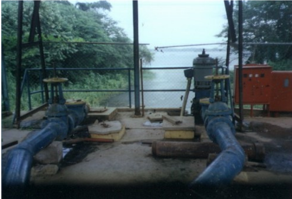
Foto 5.11. Bombas para la toma de agua para abastecimiento de Onoto. Embalse “El Cují”.
