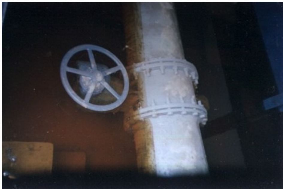
Foto 5.21. Válvula de emergencia (mariposa), inundación de la cámara de maniobras. Embalse “El Andino”.
