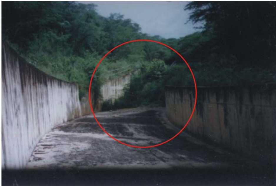
Foto 5.3. Canal rápido en buen estado, pozo disipador con abundante vegetación. Embalse “El Cují”.
