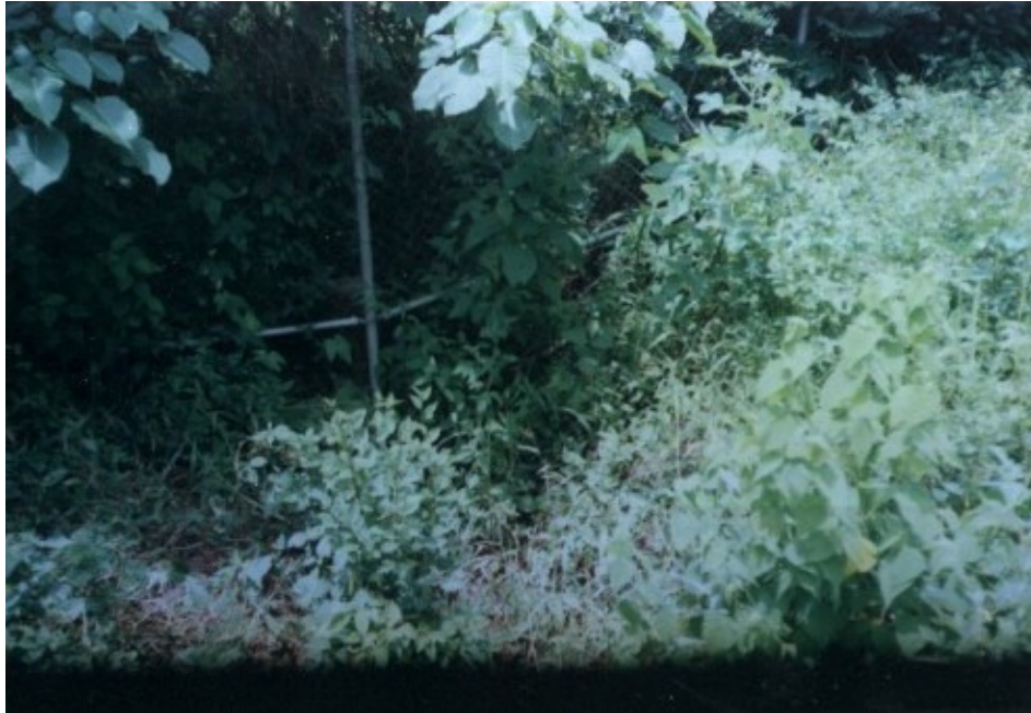
Foto 3. Cárcava en el talud derecho del aliviadero. Embalse "El Andino".
