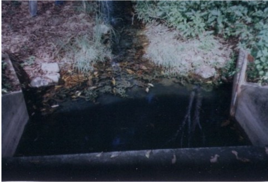
Foto 5.7. Pozo disipador de impacto y canal de descarga de la toma para riego. Embalse “El Cuji”.
