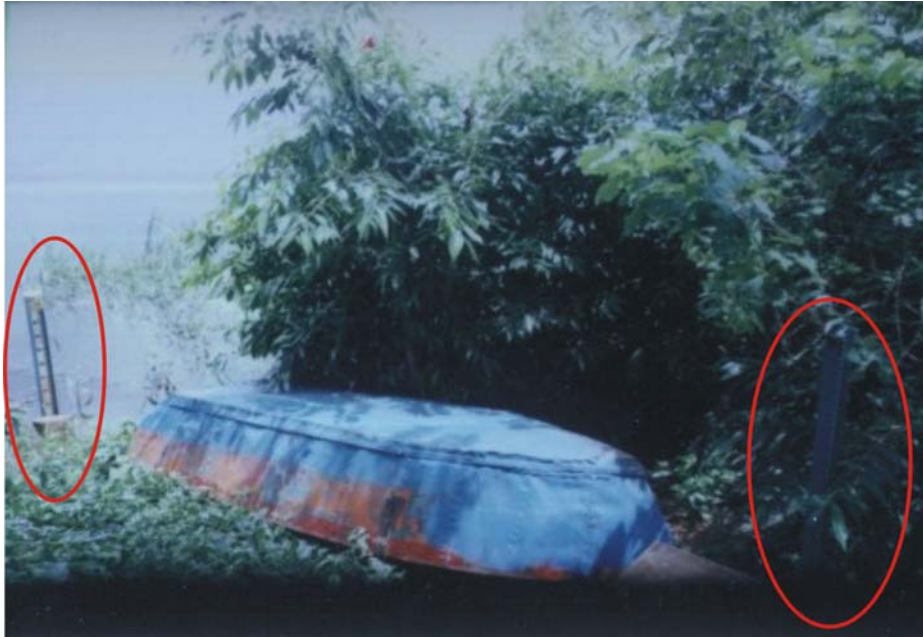
Foto 5.18. Miras de la presa, les falta la tablilla indicadora de cota. Embalse "El Andino".
