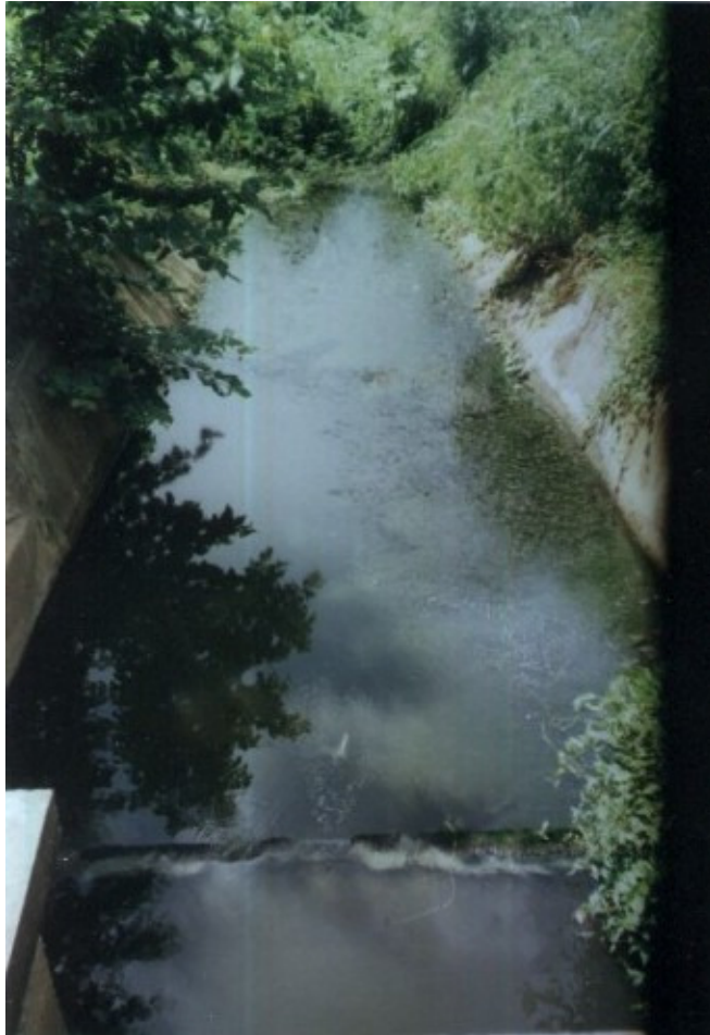
Foto 5.23. Canal de descarga de la toma para riego, obstruida por la densa vegetación. Embalse “El Andino”.
