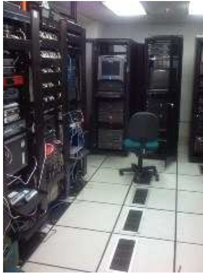
Figura 4.1: Ejemplo de rack para alojar servidores (Elaboración propia)
